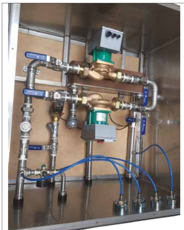
Устройство разделения системы между блоками и чиллером.
